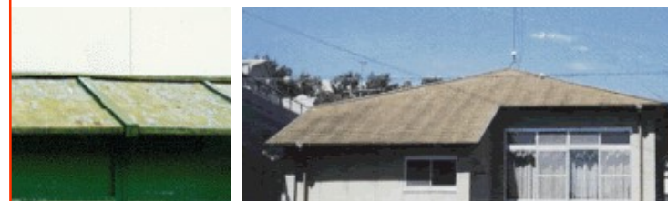
塗膜の剥れサビ
