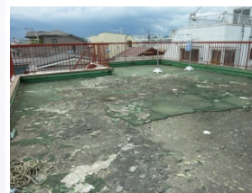
防水層の劣化による剥離
