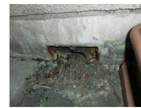
ルーフトレン錆び、劣化
