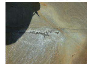
防水層のひび割れ
