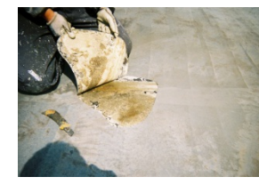
塗膜の浮き剥がれ
