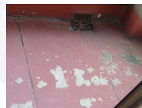
防水塗膜剥離
